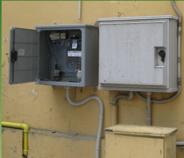
Quadro di tele-controllo
